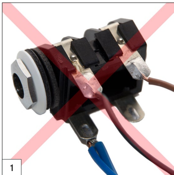
Bild [1] visar laddjacket som det var kopplat mellan v. 35 2006 – v. 10 2013, där de blå kablarna sitter på motsatta sidan om den svarta minuskabeln.
